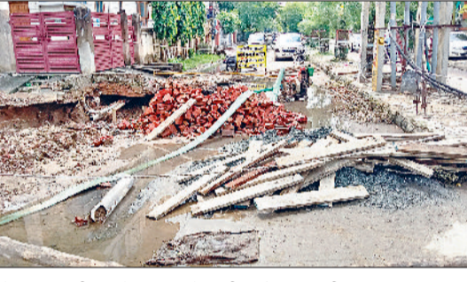
नारनौल। हुडा में भाई रामसिंह की कोटी के पास टूटी सड़क एवं भरा पानी व एडवोकेट राव पृथ्वीसिंह के आवास के समीप खोदा गया सीवर का गड्ढा।
